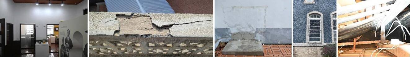
Fig. 4. 노후화된 대상 건물의 현재 상태
